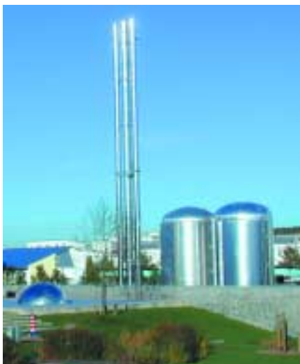
In die Solarsiedlung Amorbach in Neckarsulm ist eine innovative Nahwärmanlage integriert worden.
